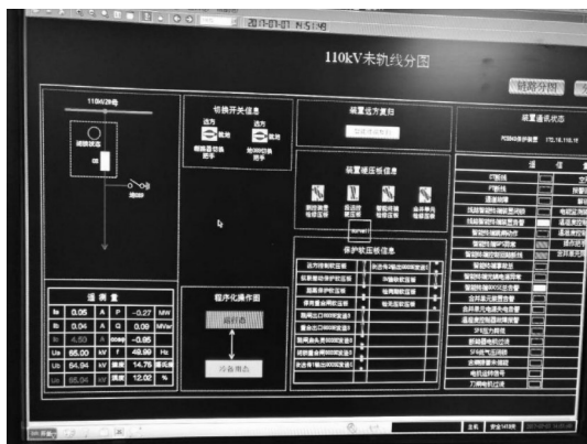
图 13 工程现场隔离断路器应用的后台显示
