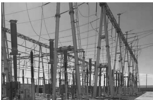
图 12 工程现场应用的电子式电流互感器
